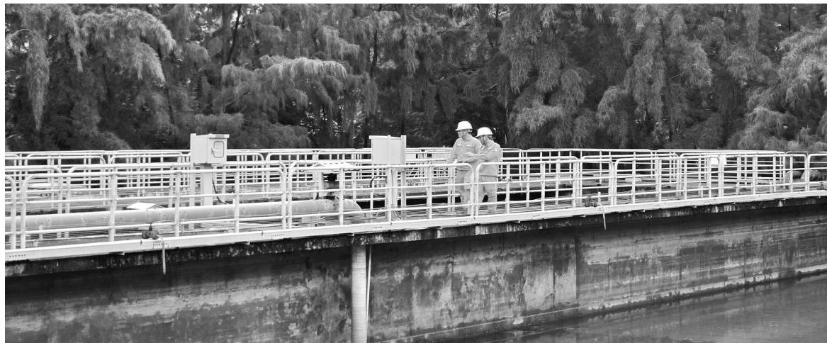
Hệ thống xử lý nước thải tại Nhà máy Nhiệt điện Duyên Hải 1
