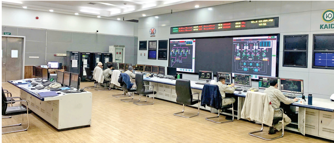
Phòng điều khiển trung tâm Nhà máy nhiệt điện Đông Triều
