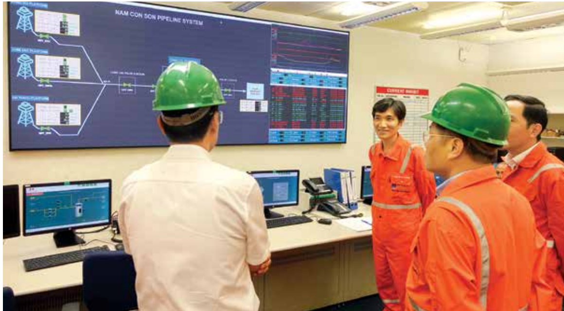
Lãnh đạo PV GAS làm việc với các kỹ sư PV GAS NCSP tại phòng điều khiển Nhà máy Xử lý khí Nam Côn Sơn
