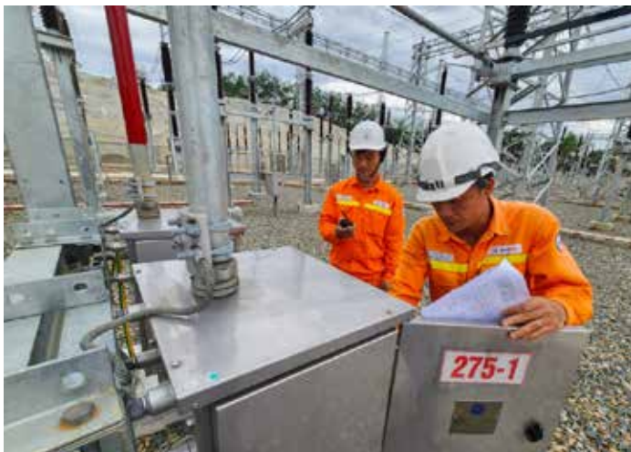
Các kỹ sư kiểm tra thiết bị tại Trạm cắt 220kV Đăk Oac
