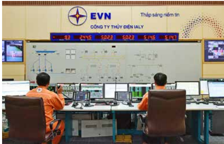
Phòng điều khiển trung tâm Thủy điện Pleikrông
