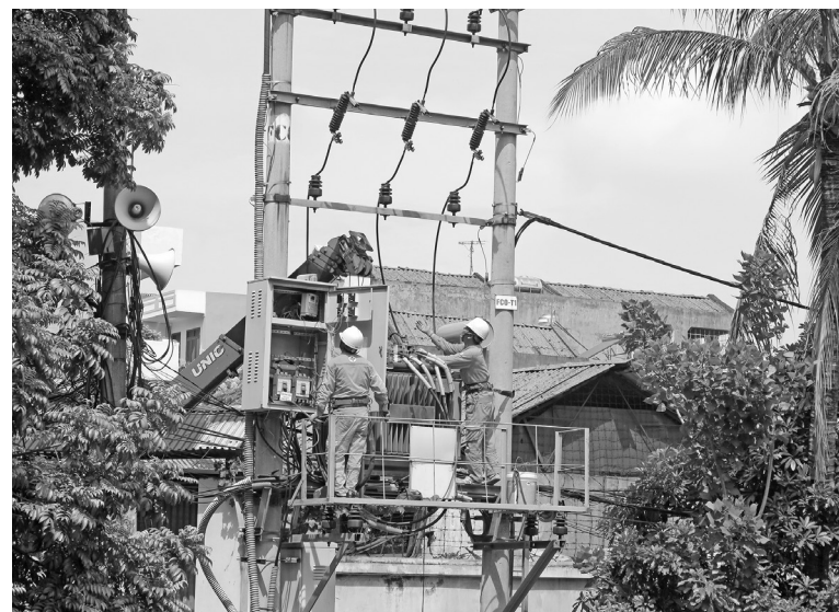
Nâng cấp và sửa chữa lưới điện tại Bắc Giang, góp phần giảm tổn thất điện năng Ảnh: Thanh Hương
